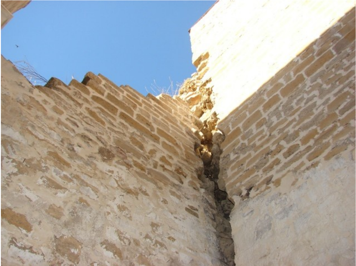
Desplome del muro I con II
