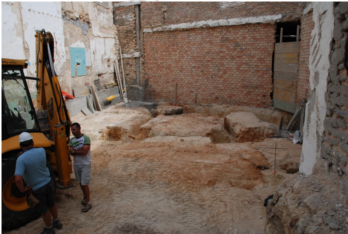
Foto 1.- Vista general del solar con las zanjas donde van las cimentaciones del edificio
