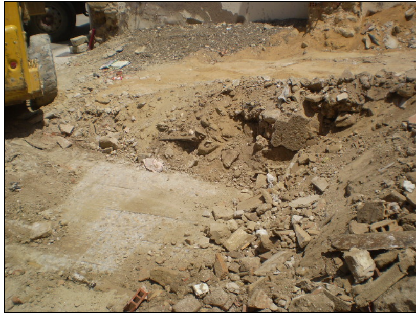
Lám. 2 Solería de terrazo debajo del escombros.
