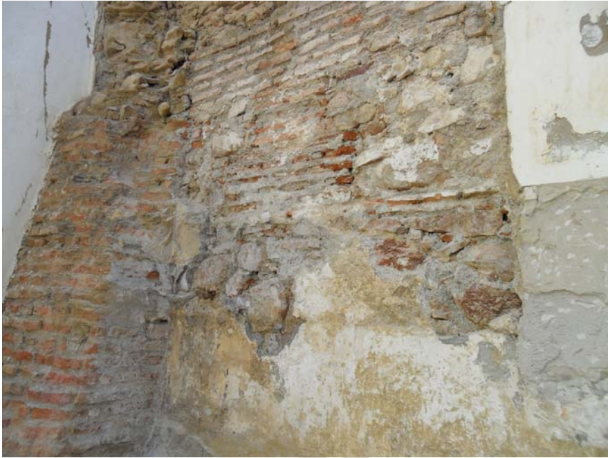
lám.1. En la Z-I U.E.C. 10. Contrafuerte del Acueducto adosado en la medianera izquierda.
