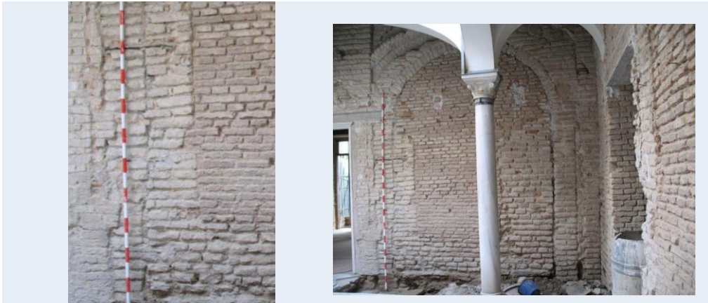
Grapas de metal y de madera documentadas en el cegamiento de los antiguos arco de la estancia 5 (alzado I-I')
