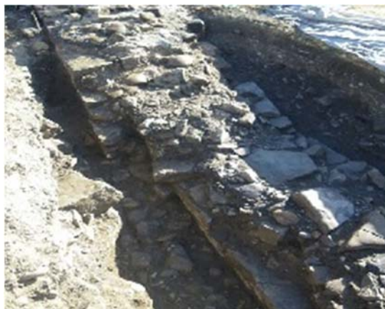
Figura 14. Detalle de la limpieza de la muralla sureste. Se puede observar el irregular entronque de ambas mitades, posiblemente fruto de reparaciones en la misma.
