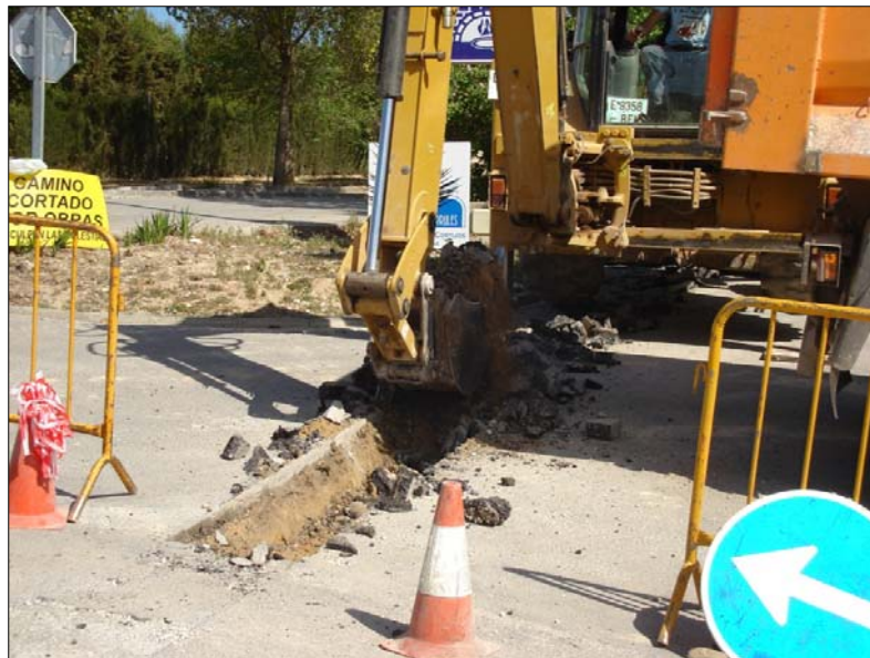
Lámina 8: Ejecución de la zanja en la entrada a la urbanización de Los Cortijos.
