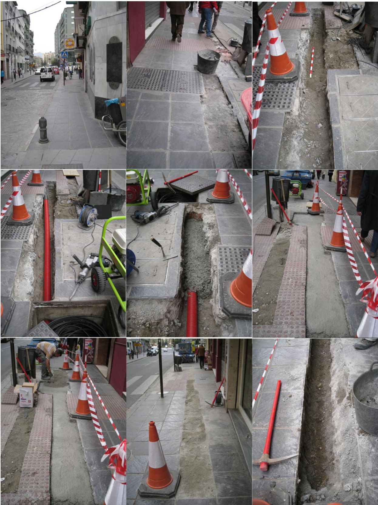
Ilustración 4: Desarrollo del proceso de apertura de la zanja, inserción del tubo y cubrición.
