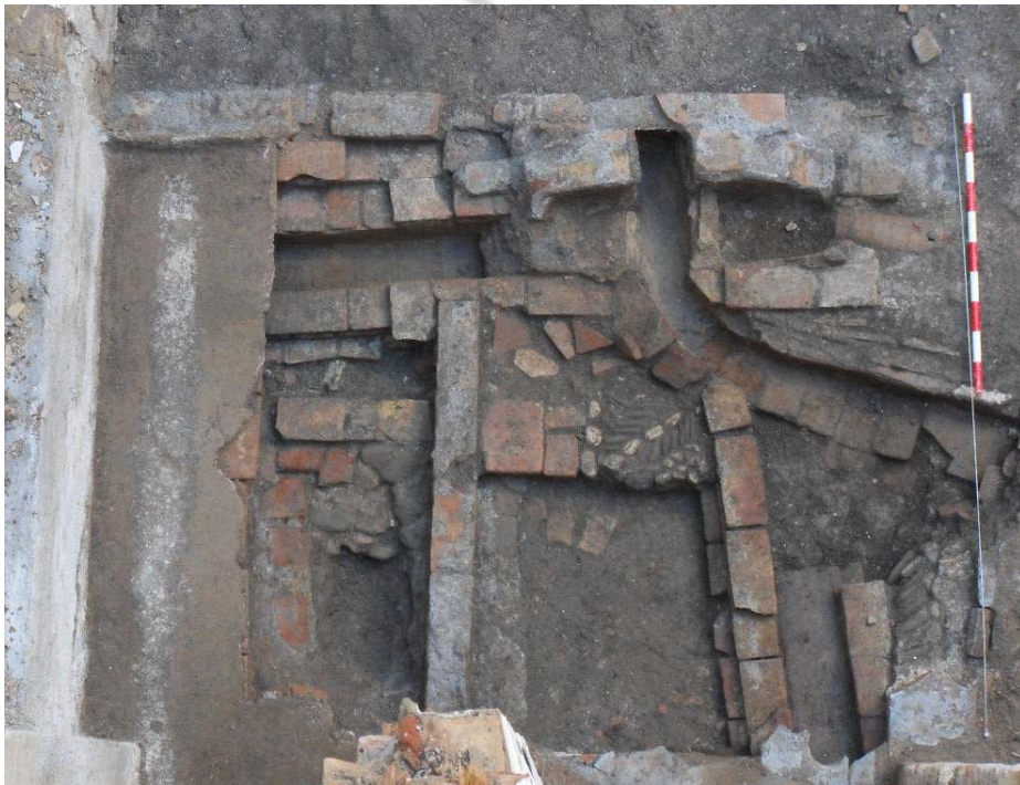
Vista general del sondeo en la que se aprecian restos de suelos y el sistema de saneamiento actuales
