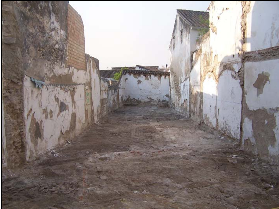
Lámina I. Vista del solar una vez concluido el control de movimientos de tierra.
