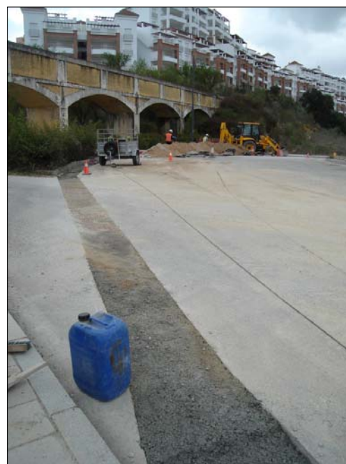
Lámina 15: Vista de Canal de Cubillas (Elemento Etnológico nº2) durante la realización de las obras.
