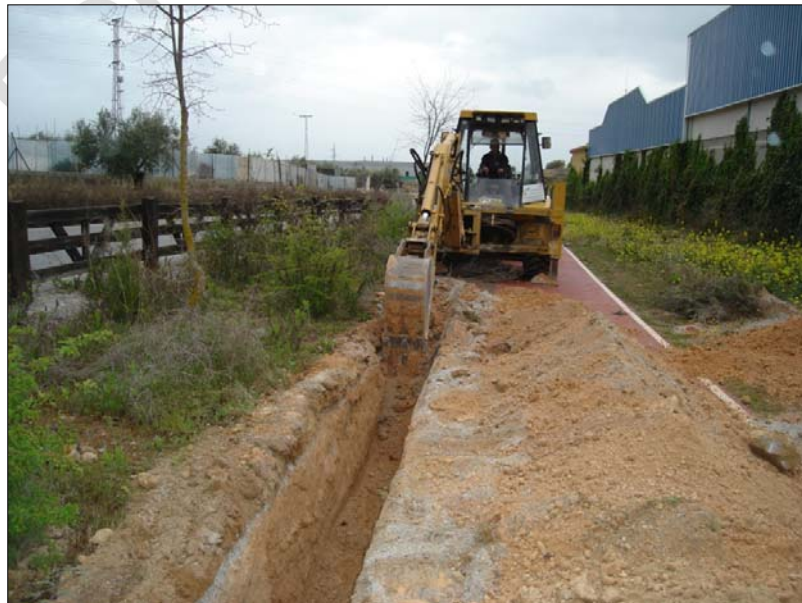
Lámina 3: Ejecución de la zanja en el tramo 2, entorno del B.I.C. de Medina Elvira
