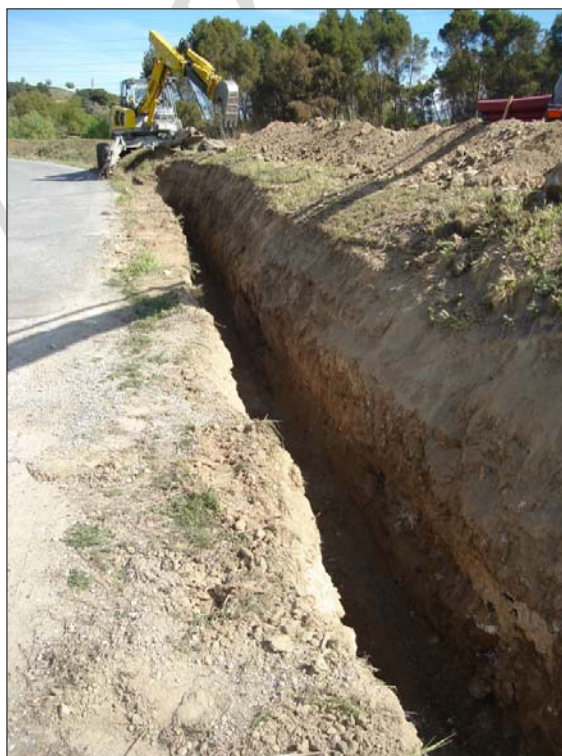
Lámina 7: Ejecución de la zanja entre la Urbanización Medina Golf y Los Cortijos
