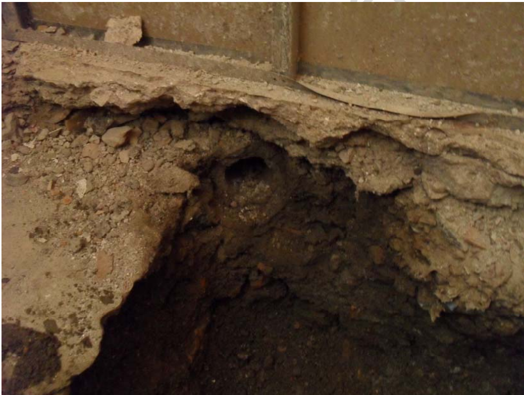
Lámina 2.-Esquina oriental del hueco con los primeros niveles señalados. Obsérvese la Ue. 5
