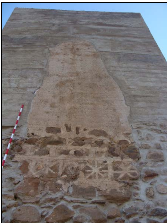
Lám. I. Vista final del frente norte de la torre, en la parte inferior la decoración geométrica tras su restauración y consolidación.
