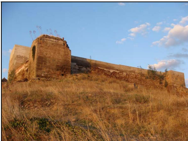
Lám. E. Estado previo de la torre noreste del primer recinto del castillo.
