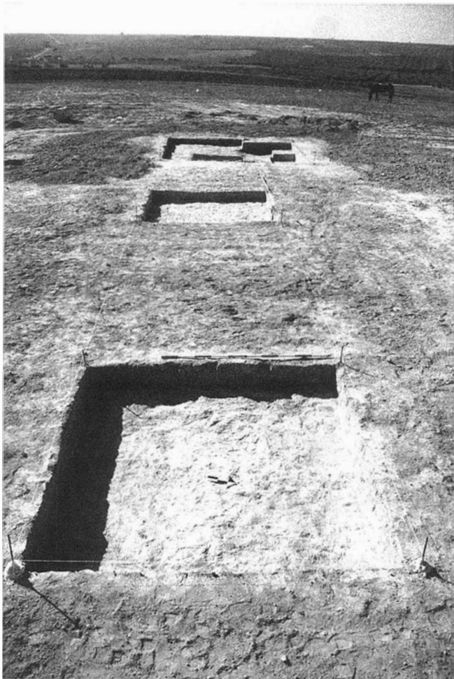
LAM. I. Vista general de la unidad de intervención A, tras la finalización de los trabajos.
