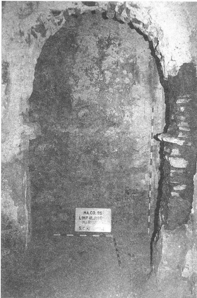
LÁM. IV. Vista de uno de los tramos con el pilar consolidado.
