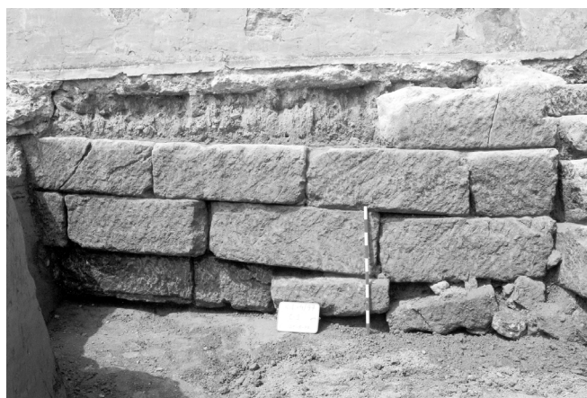
LÁM. I. Alzado del muro romano isódomo del Corte 1 (U.E. 45) correspondiente al límite E. del kardo .
