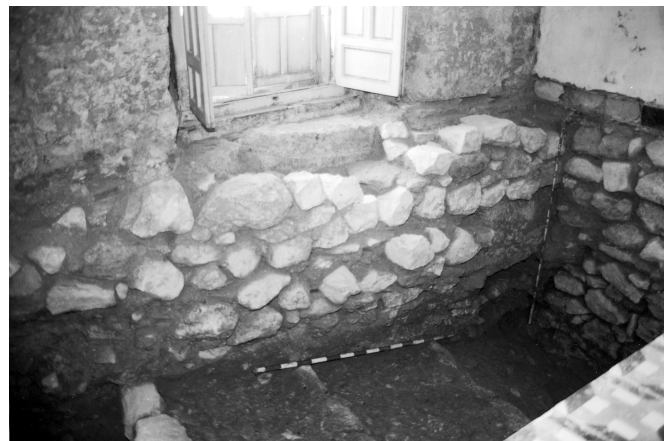
LÁM. VI. Corte 5. Alzados de las cimentaciones de la fachada y medianera norte de la casa.
