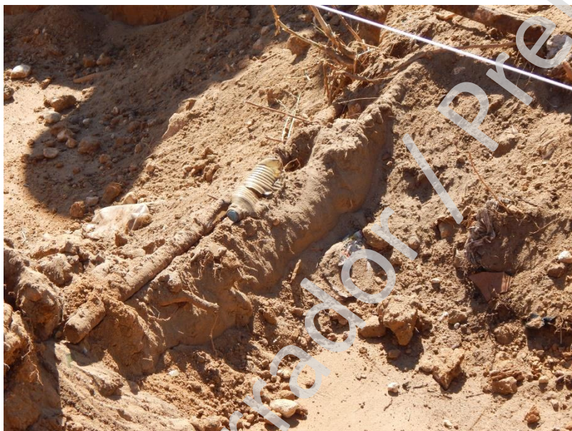
Detalles de las basuras y demás vertidos que aparecen en la UE2.
