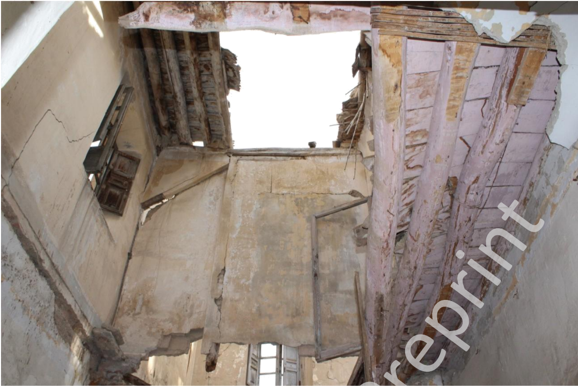
Interior de la crujía sur, cubiertas y forjados colapsados en el interior. Estado previo crujía oeste
