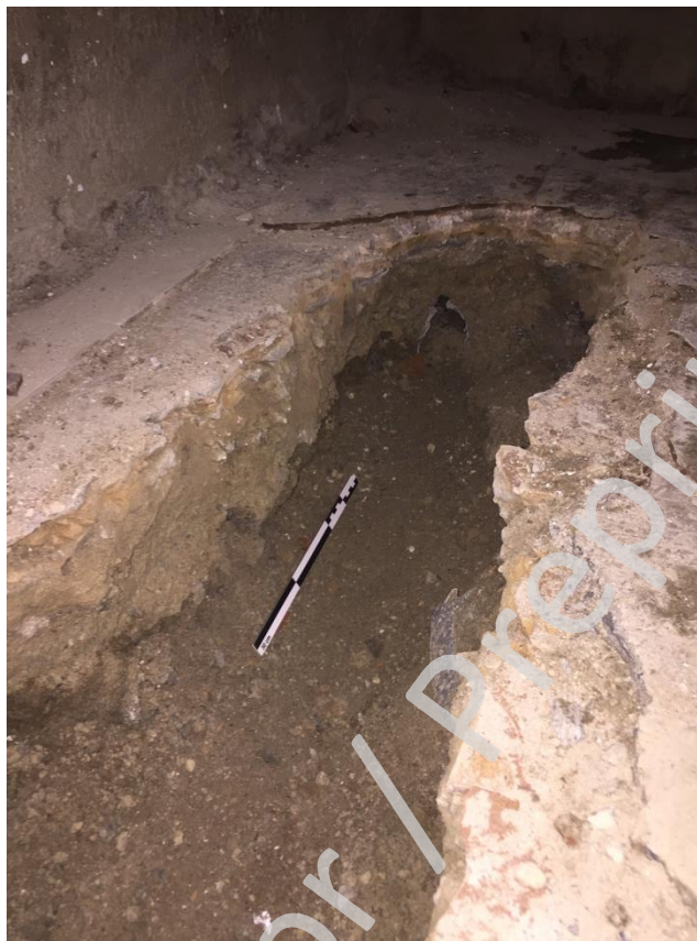
Figura 5. Aspecto del ramal menor del baño una vez realizado. Al fondo se aprecia el tubo de PVC de la instalación precedente, parcialmente solapada a la nueva y afección de rellenos.
