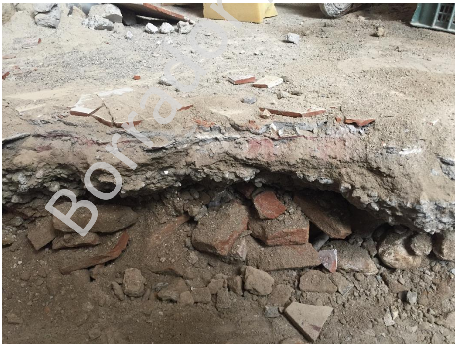
Figura 4. Rellenos de cascajo bajo la solería de baldosas y plancha de cemento del patio interior de la vivienda anterior.
