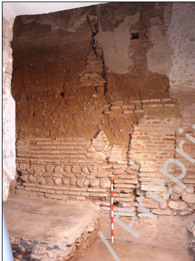
Detalle de la fractura en la pared producida por un terremoto. La misma está reparada mediante parches de ladrillo.
