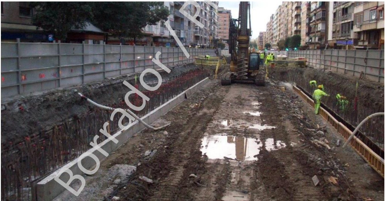
Detalle de la excavación del aglomerado para la construcción de la losa superior
