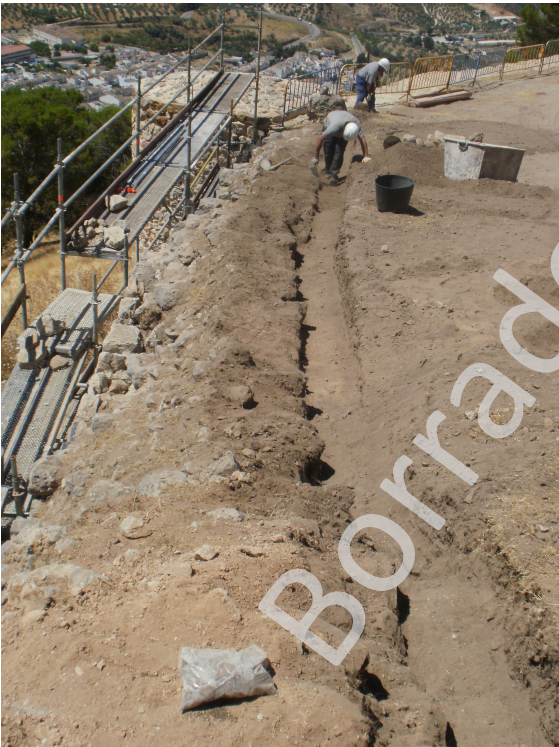
Inicio de los trabajos de limpieza y restauración de la cerca en el sector 2. Detalle de la trinchera para comprobar el careo interior de la muralla.
