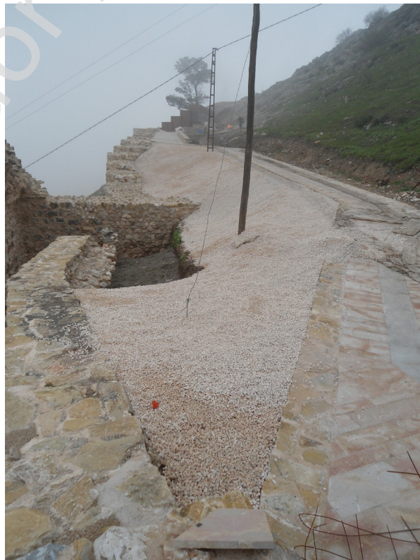
Camino terminado en el entorno de la Puerta de la Ciudad y el tramo de muralla 15.
