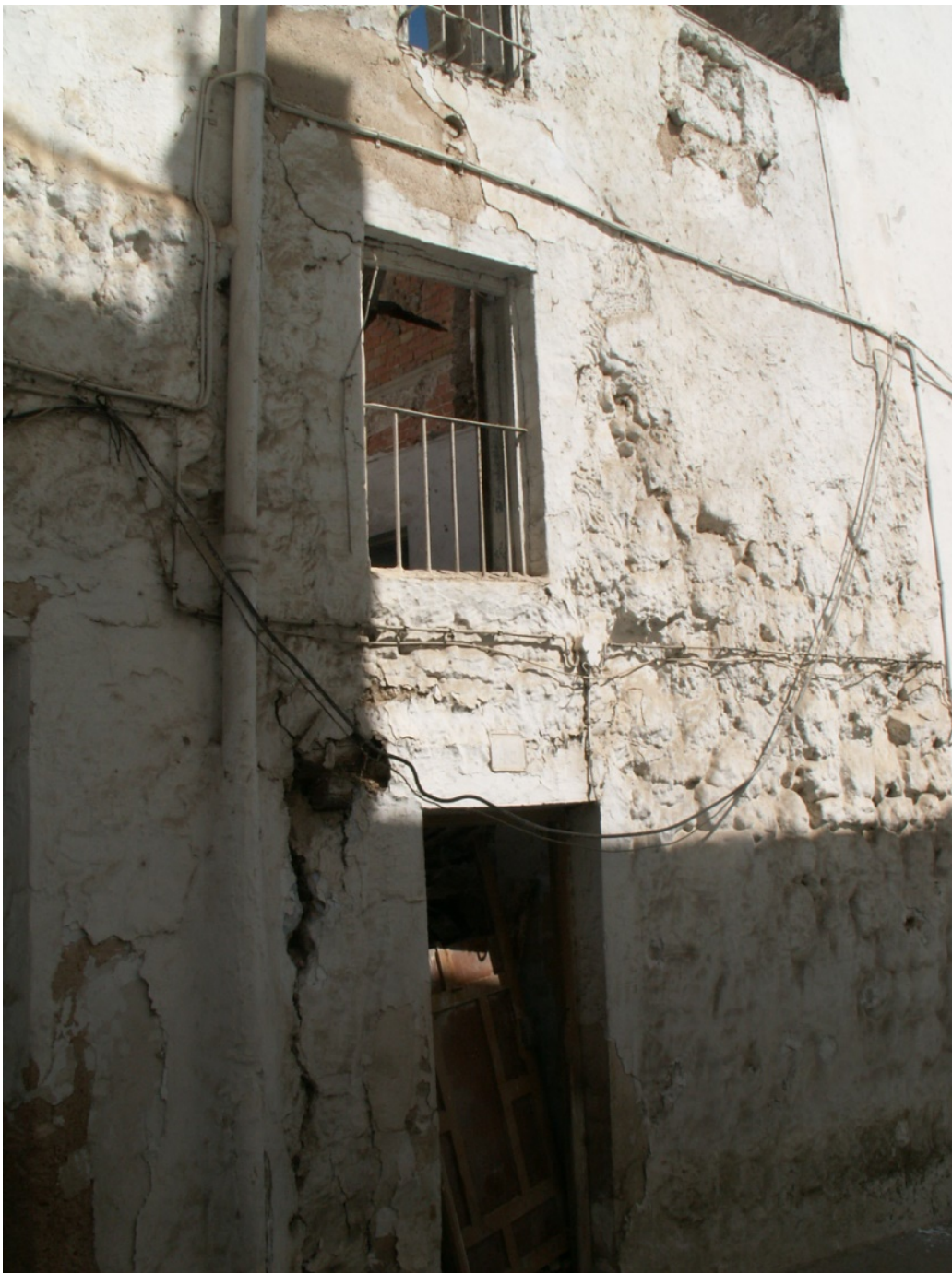
LAMINA 1. Estado original de las fachadas de los inmuebles 45 y 47
