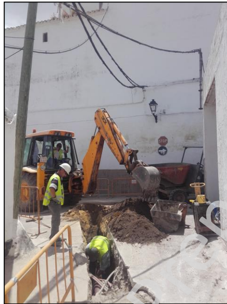
Lámina III: Detalle los trabajos de apertura de la zanja en Callejón del Agua
