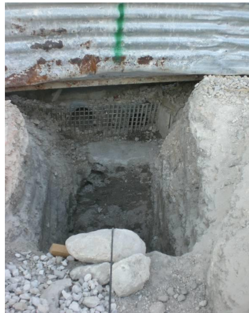
Lám. IX. Acometida de saneamiento del edificio.
