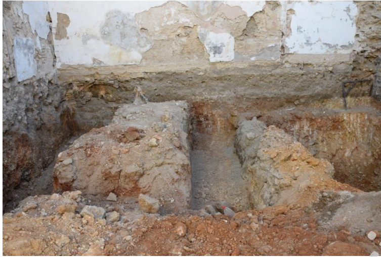
Figura 3. El sector SE del solar tras la apertura de los cimientos y piscina.
