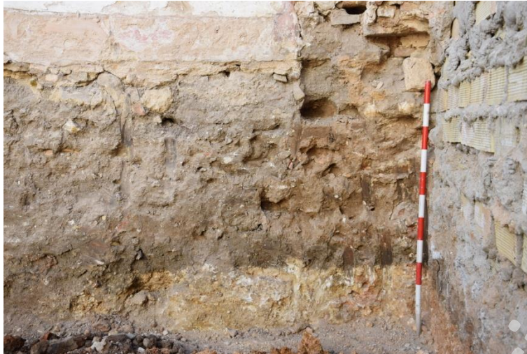
Figura 4. Detalle de la esquina SE del solar donde se evidencia la altura de la roca donde se apoyó la cimentación del muro medianero.
