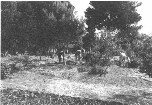
LAM. 7. Deterioros producidos por plantas en el Segundo recinto, evidenciados tras su tala.
