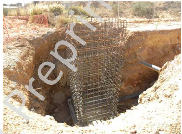
Fotografía 84: Arqueta en PK 10+600.
