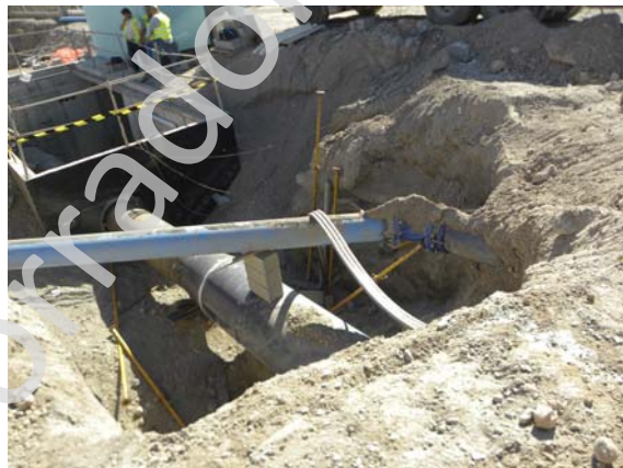
Fotografía 85: Arqueta en PK 22+000.
