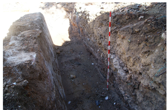
Nivel de escombros tras muro de contención
