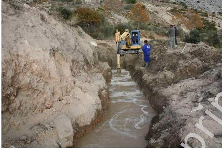
Foto 9: Se observa la zanja llena de agua
