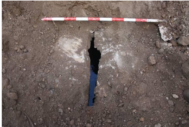
Foto 5: Detalle de rotura del tubo de fibrocemento
