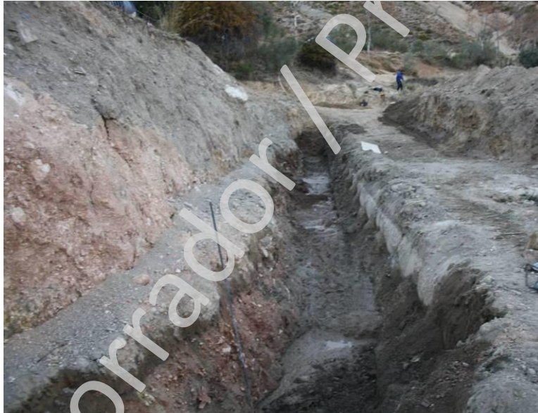
Foto 10: detalle de la zanja una vez que se cortó el agua de la acequia, junto a la zanja se puede observar el tubo de fibrocemento preexistente.
