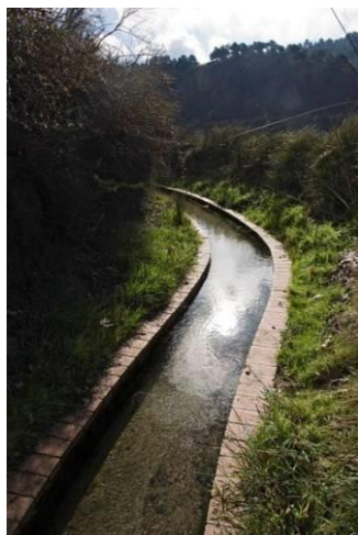
Foto 4: estado actual de la acequia de Aynadamar
