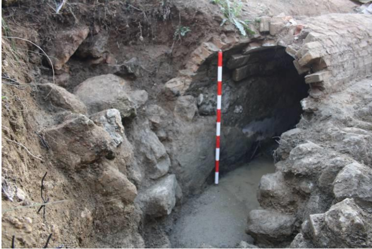
Foto 14: Detalle del estado final de la salida de la bóveda
