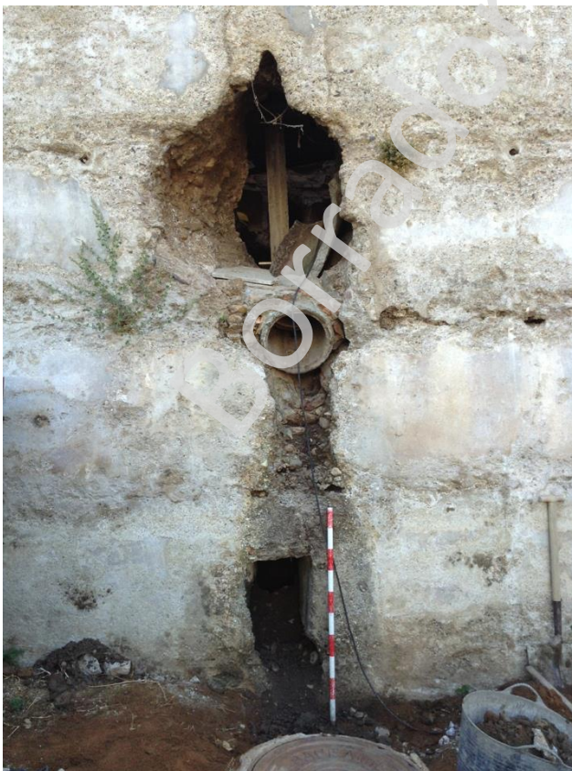
Detalle del alzado exterior de la muralla, con el hueco a restaurar, el tubo que se ha sustituido y la salida de aguas localizada.
