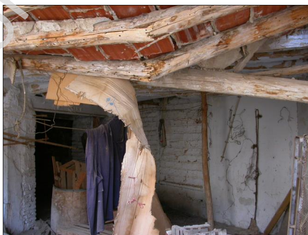
ESTADO DEL TECHO (PLANTA PRIMERA) DE LOS COBERTIZOS TRASEROS
