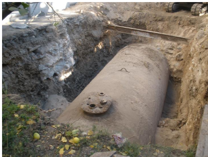
Lam. 9. Depósito de gasoil (U.E.C. 4)
