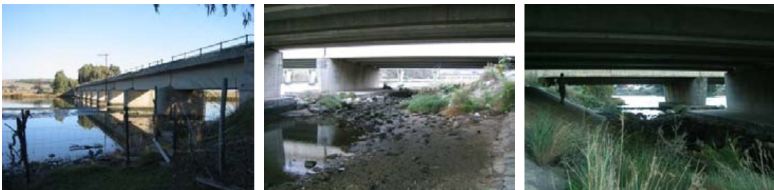
Puente del ferrocarril y dos vistas del puente de la A-7 (antigua N-340) sobre el río Palmones.
