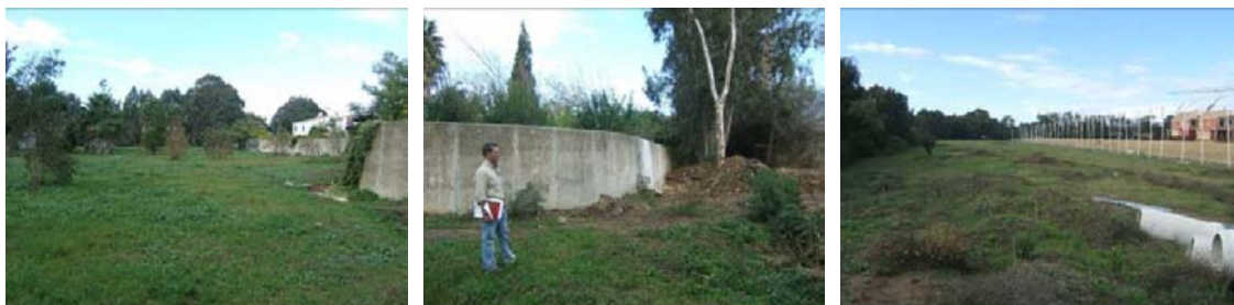
Aspecto actual de muro de defensa de hormigón de la urbanización "Mirador del Río". La última imagen se corresponde con los rellenos de la urbanización "Huerta de En medio".
