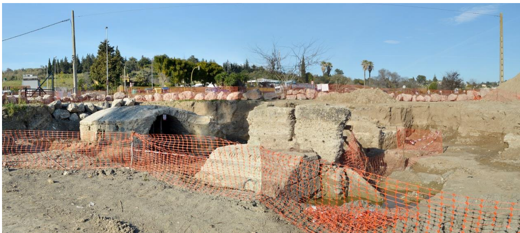
Excavación del complejo, que había quedado enterrado por sedimentos tras el traslado del azud.
