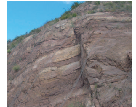
Riesgos de desprendimientos
