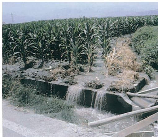
Figura 14. El agua de escorrentía debe ser adecuadamente recuperada, evitando su vertido incontrolado y la posibilidad de contaminación ambiental.
