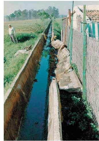
Figura 3. Canal de riego en muy mal estado de conservación.
