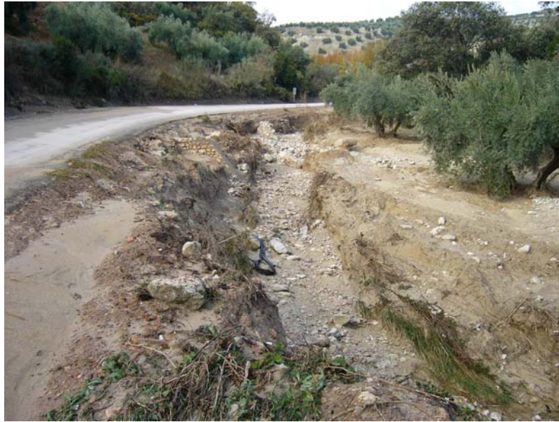
Arrastres del arroyo Morellana
