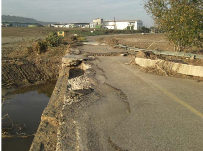
Desperfectos producidos por avenida del Arroyo Salado (Santaella)
