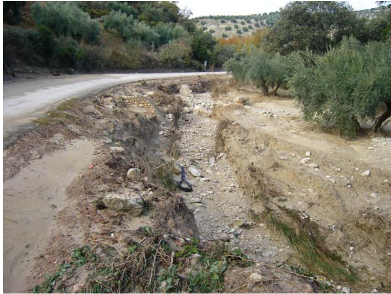
Arrastres del arroyo Morellana
