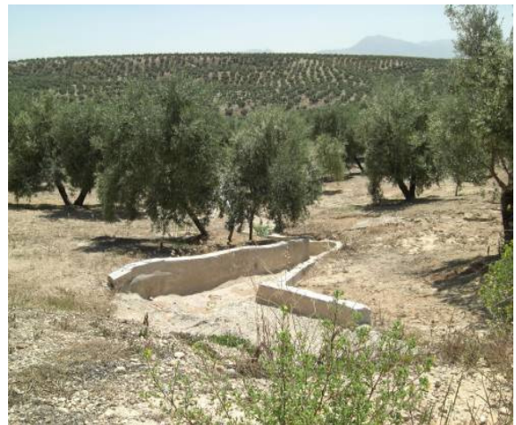
Canalización para aguas pluviales en zona de campiña olivarera (Villatorres)
