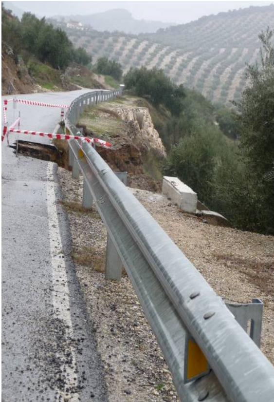
Problemas de erosión en carretera
