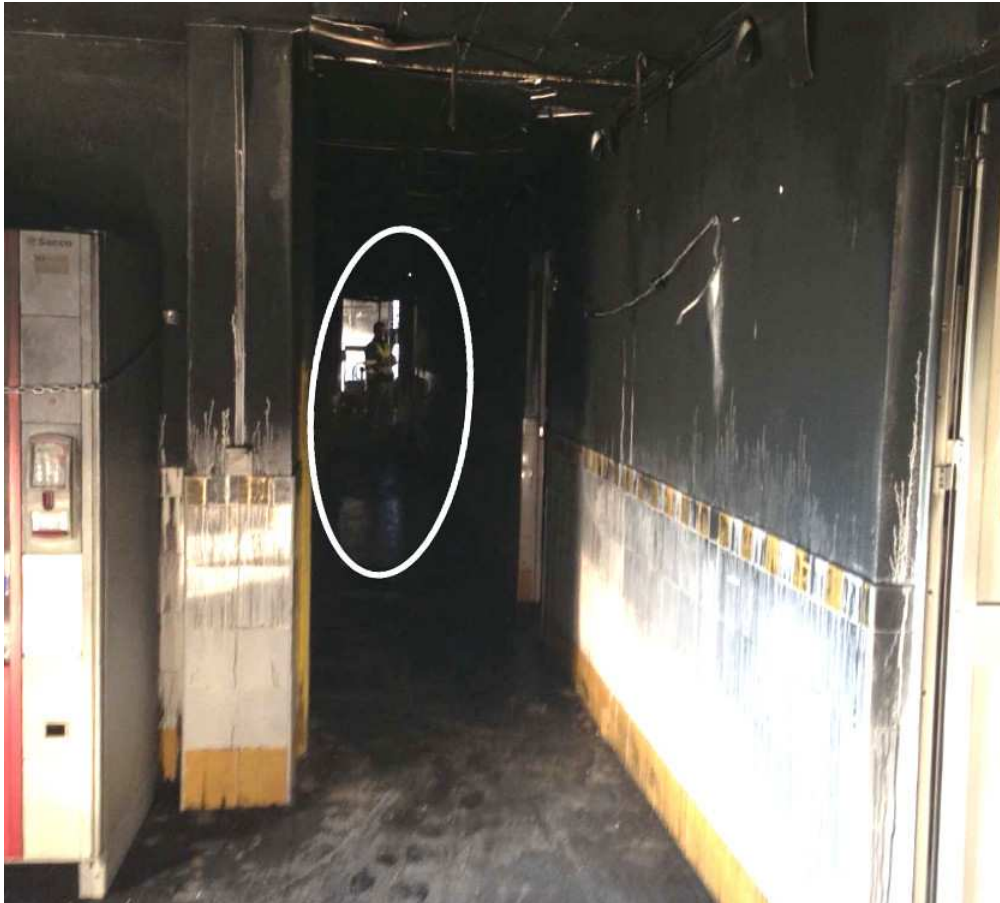
Imagen 2. Estado en el que quedaron las instalaciones. Al fondo, en blanco, entrada a habitación incendiada.
