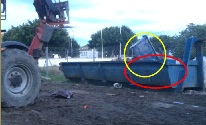
Lugar del accidente. En rojo, donde quedó atrapado el operario. En amarillo, cubeta que se iba a descargar.
