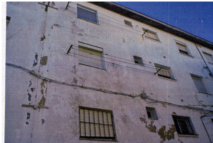
Fotos 8, 9 y 10. Fisuras en fachada. Humedades y suciedad. Desprendimiento de la pintura
