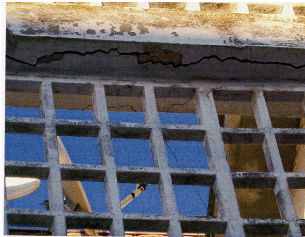
Foto 6. Grieta en viga de patio extremo
