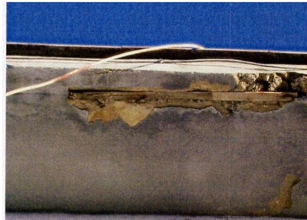
Foto 4 y 5. Desprendimiento del revoco de la cornisa. Mala ejecución por olvido de berengeno en el interior. Falta de goterón
