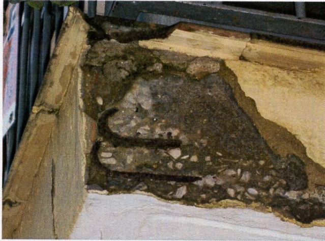
Foto 1. Falta de zuncho de borde en balcon. Corrosión de las armaduras con desprendimiento del revoco
