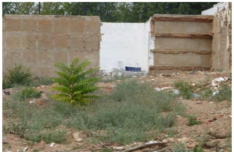
Zona noreste del cementerio. Lugar donde ubicaría la fosa 2. Antes y después de la demolición de los nichos.
