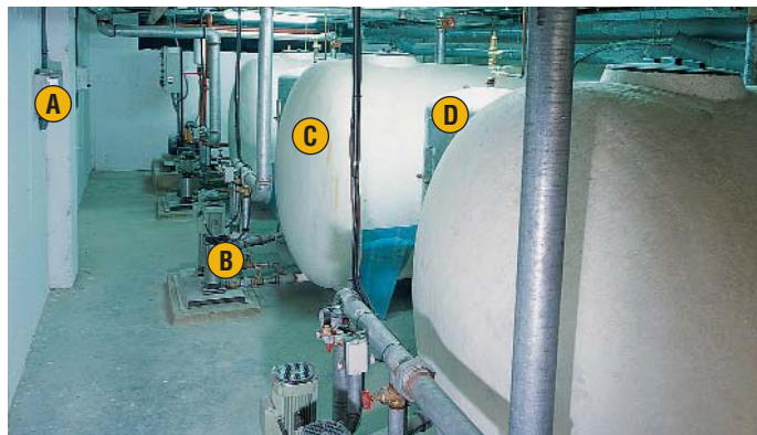
6. Grupo de presión para red de abastecimiento de agua potable: A. Cuadro de mando de las electrobombas. B. Electrobombas del grupo de presión de agua potable. C. Depósito acumulador (algibe). D. Equipo hidroneumático.
