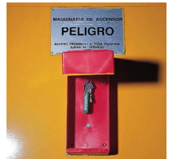
15. Puerta de entrada a sala de máquinas con su llave de acceso.
