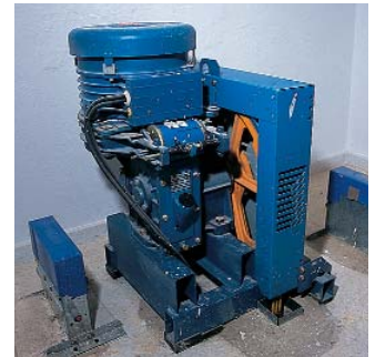
14. Maquinaria de ascensor.
