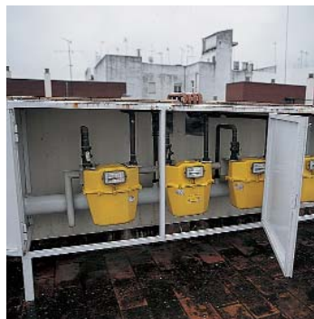
20. Batería de contadores y llaves de corte.
