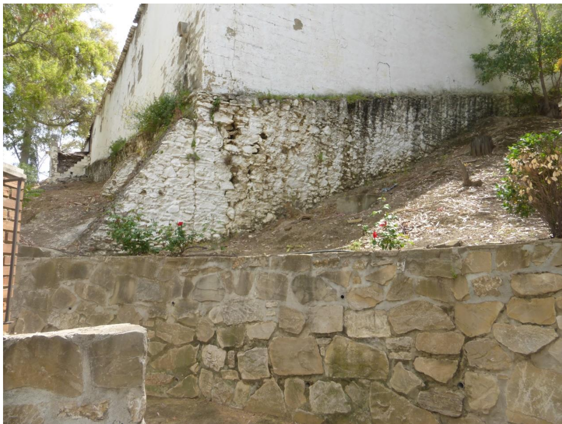
Tapia de cerramiento del sector Noroeste, es el punto más débil del cementerio, lugar de posible desplome de los nichos.
