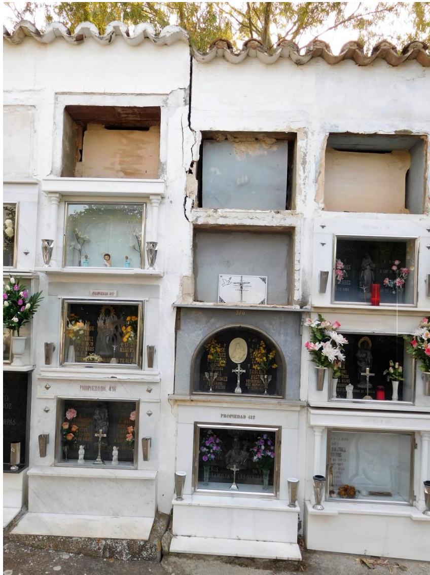
Estado ruinoso de los bloques de nichos que se construyeron por encima de la tapia de cerramiento Norte.
