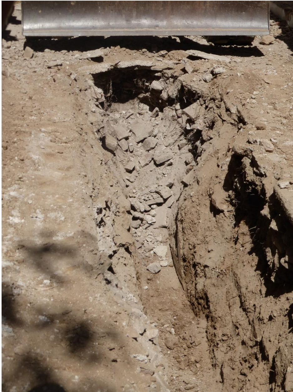
Capa de escombros entre los rellenos documentados en la cata realizada.
