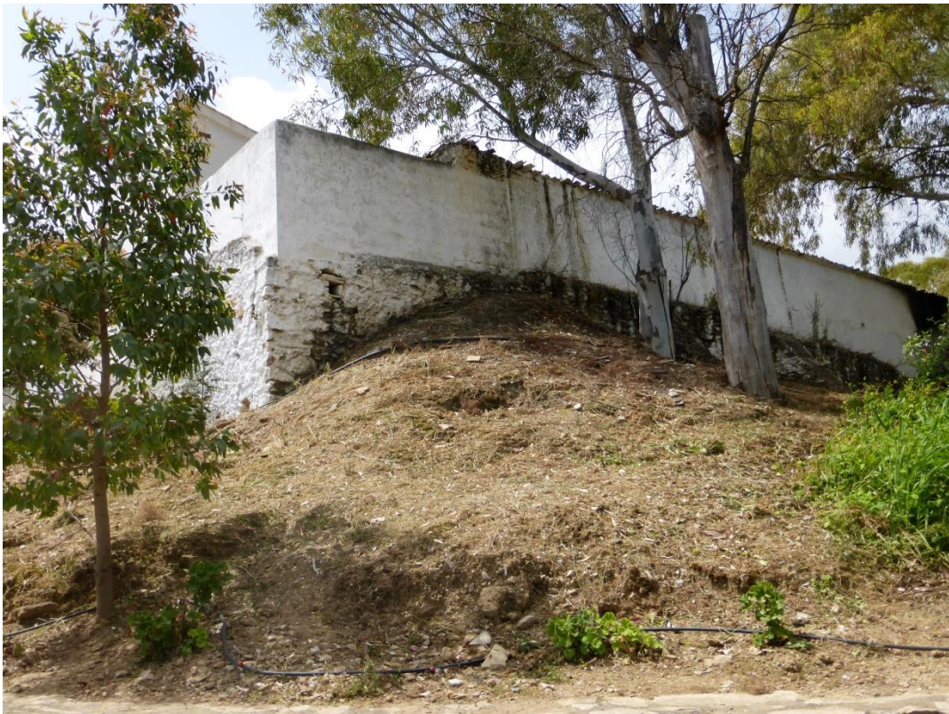
Tapia externa del cementerio, esquina Noreste, se aprecia como los bloques de nichos se han construido por encima de la tapia de cerramiento.
