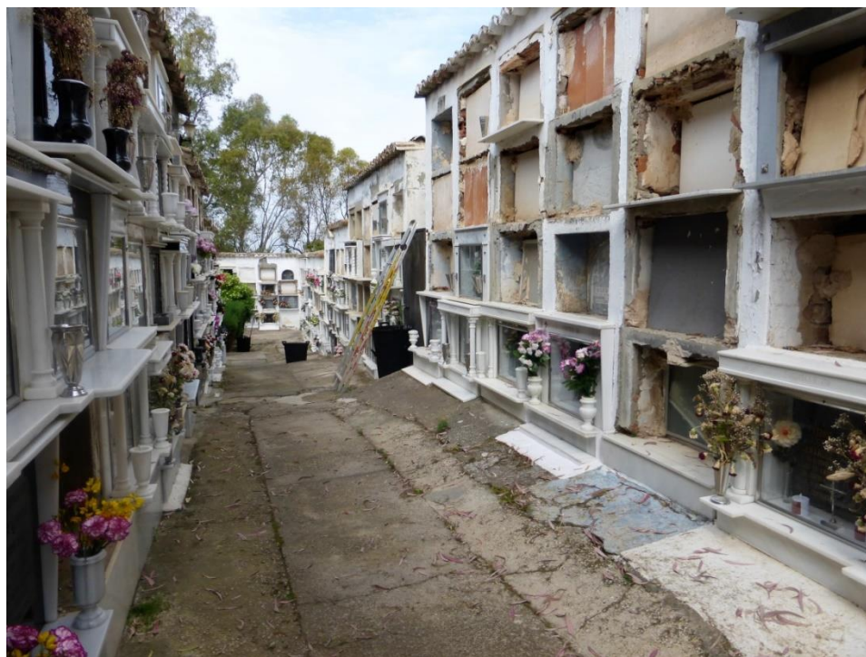
Estado de los bloques de nichos en el sector Norte.
