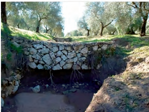
Figura 42. Colapso de un dique por socavación. Este dique de piedra mallada fue ejecutado sin cuenco de amortiguación.
