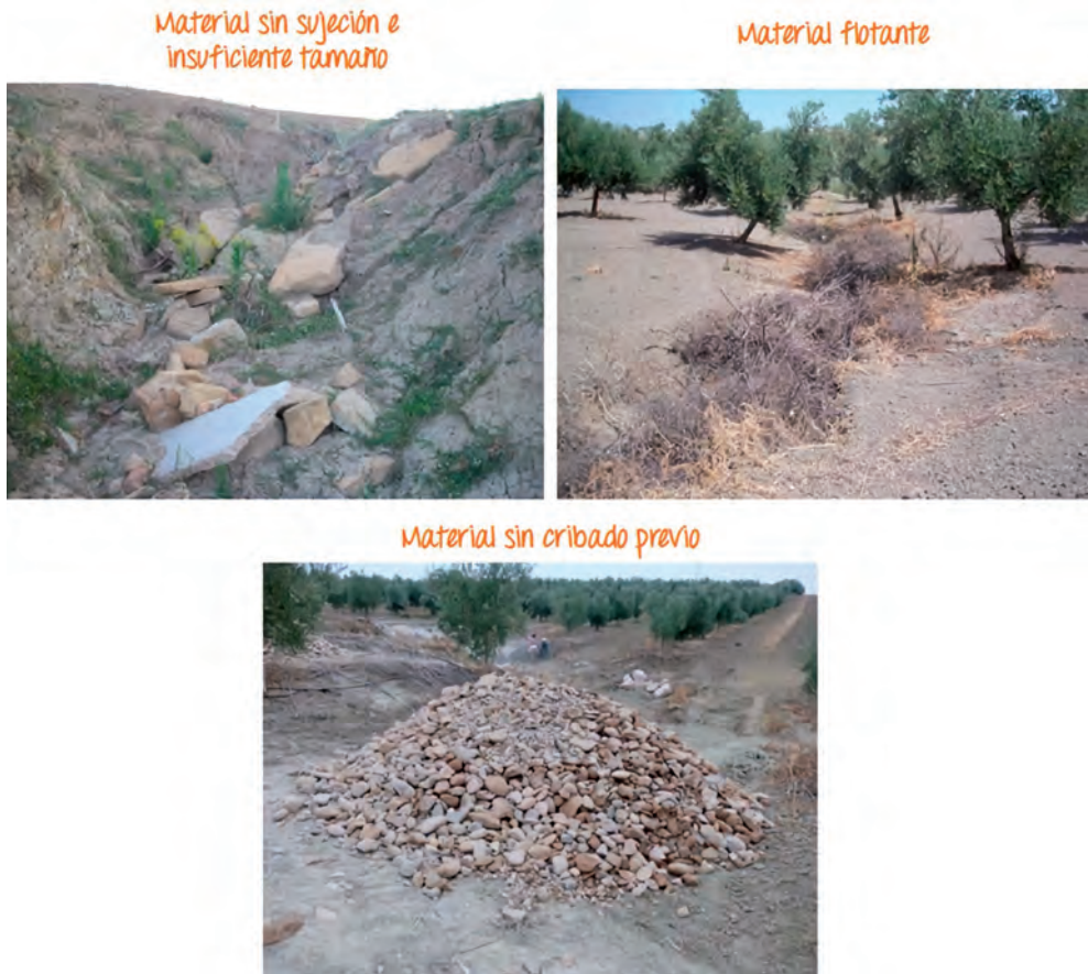
Figura 44. El vertido de material suelto no suele tener efectos positivos en el control de las cárcavas dada la fuerza de arrastre de las aguas de escorrentía. Si los materiales no son de gran tamaño deben encerrarse en una malla para evitar ser arrastrados. Materiales vegetales (como pacas de paja o ramas de olivo) tampoco son efectivos dada su flotabilidad. Ambas estrategias presentan el inconveniente adicional de no canalizar de forma segura la escorrentía en la parte central del cauce. En la última imagen se muestra bolo de tamaño inadecuado (incluye finos y zahorra) que puede pasar a través de la malla de gavión y perderse.
