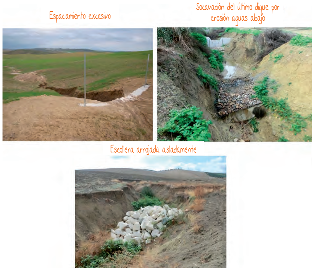
Figura 46. Diferentes deficiencias en el diseño la actuación de diques de retención (espaciamiento y ubicación del último dique en zona no segura). La tercera imagen corresponde a la descarga aislada de material 'apropiado' en una sección de la cárcava pero sin diseño (anclaje, vertedero, cuenco de amortiguación) y en exceso. En ocasiones se realizan actuaciones que implican un coste elevado pero de eficacia reducida.
