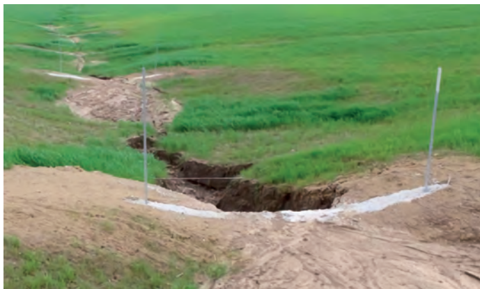
Figura 12. Vista de una restauración de una cárcava con diques de hormigón en una finca de Santaella (Córdoba). En los tramos superiores, los espaciamientos excesivos, han originado erosión aguas abajo del dique (solapamiento alrededor del 40% en los dos últimos diques). Obsérvese el efecto de protección de la cuña de sedimentación aproximadamente a una distancia definida por el criterio de nivelación.
