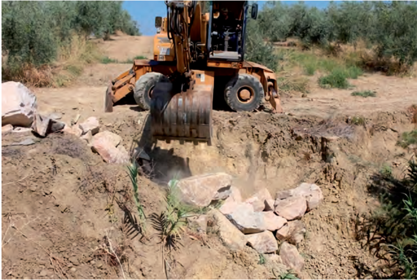
Figura 8. Protección de la cabeza lateral de una cárcava mediante escollera. Para trabajar con escollera es necesario contar con maquinaria pesada (en este caso giratoria de 18 T) y un maquinista experimentado.
