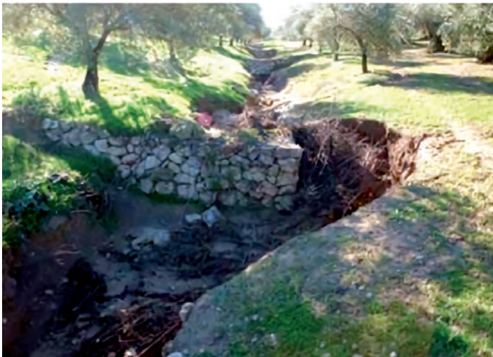
Figura 41. Colapso de un dique por erosión lateral. Este dique de piedra mallada fue ejecutado sin aliviadero.
