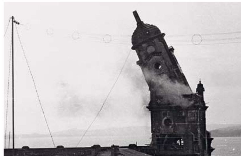
Demolición de la torre de la Catedral de Ancud posterior al terremoto y maremoto de 1960.
